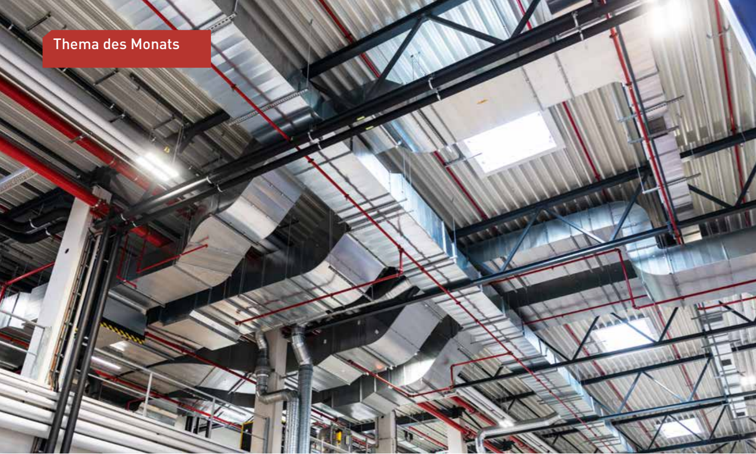
▲ Viel Technik unterm Hallendach: Blick auf die Unterseite der Tragkonstruktion im Produktionsbereich, die aus Stahltrapezprofilen besteht
