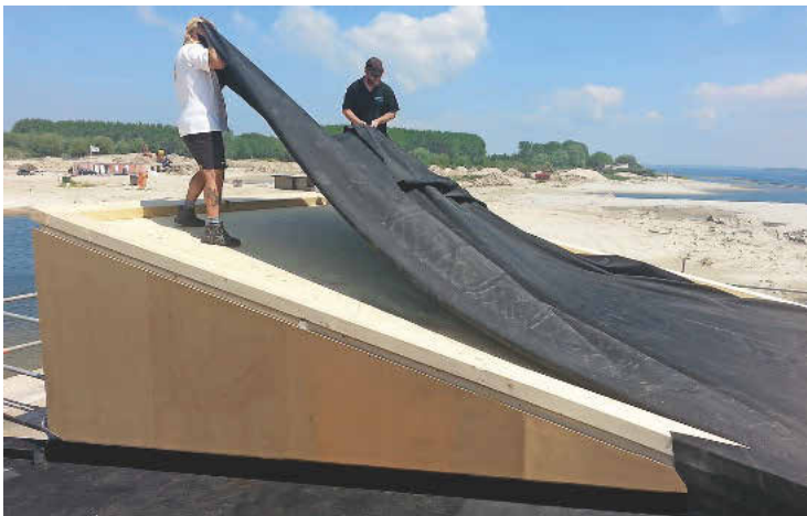
Die OSB-Dachplatten wurde mit dem Flächenkleber versehen, der die hier aufgelegte, großflächige EPDM-Plane windsog-sicher fixiert.
