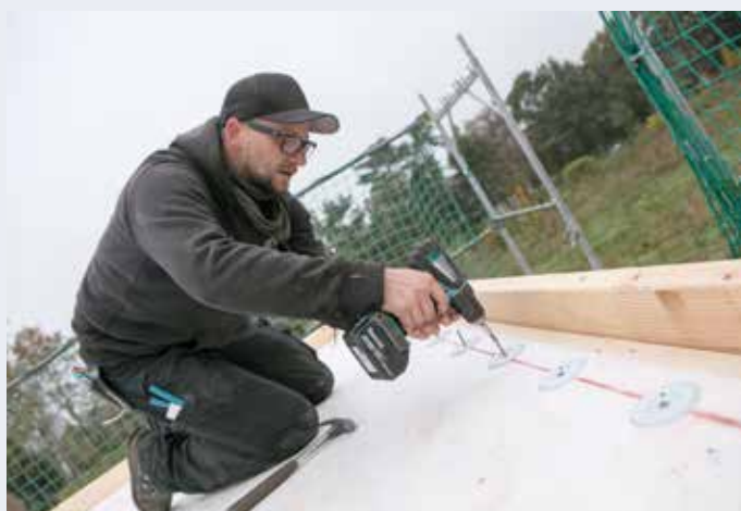
Die »RhinoBond«-Halteteller wurden entsprechend dem aus der Windlastberechnung und den Herstellervorschriften festgelegten Verlegemuster auf dem Dach befestigt.
