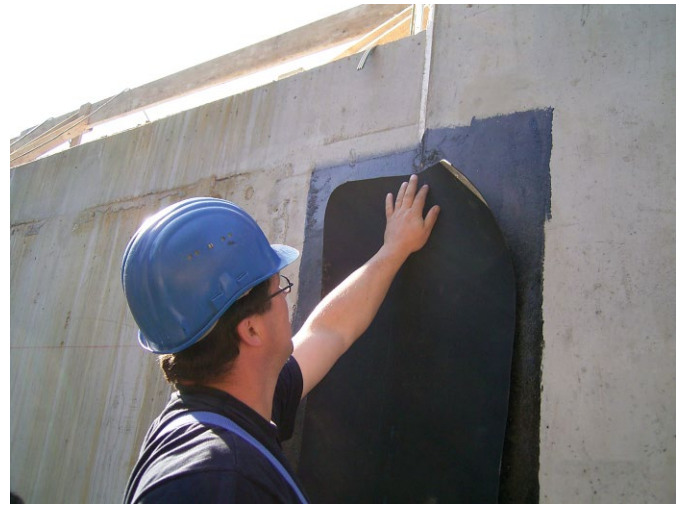
Bild 4. Abdichtung von Arbeitsfugen innerhalb einer WU-Betonkonstruktion mit RESITRIX® SK W Full Bond (Fotos: Carlisle)
