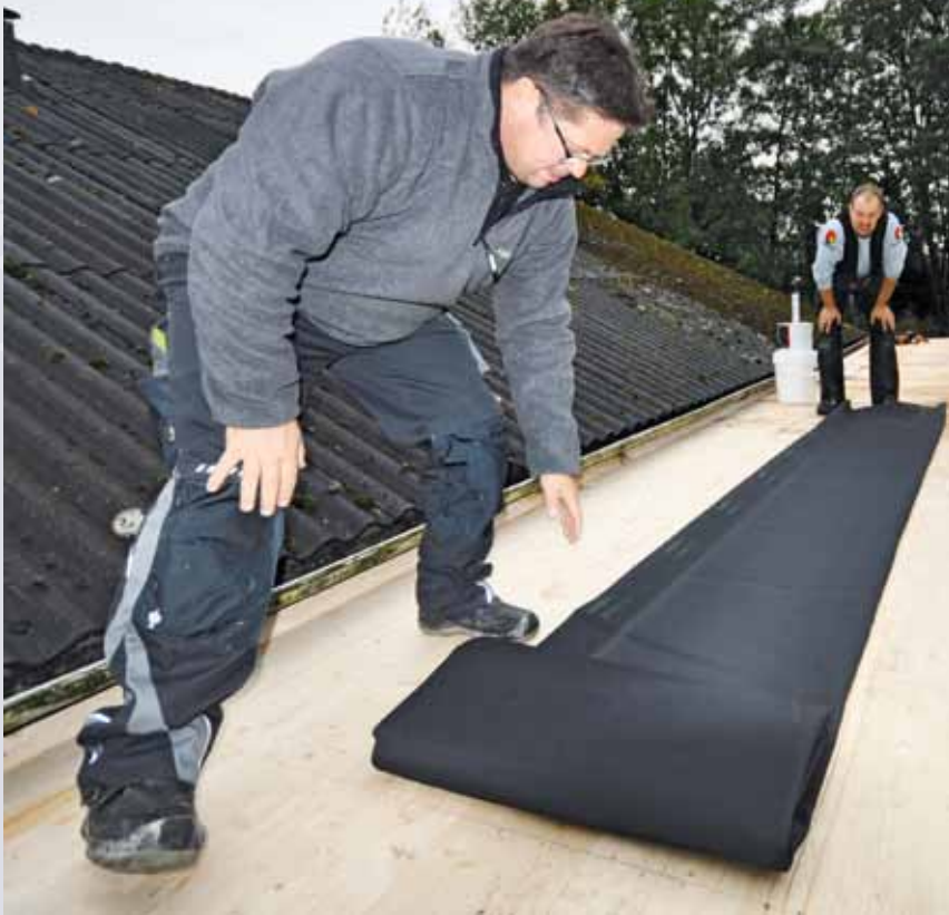
Abdichtung von der Rolle – zwei vorkonfektionierte Bahnen dienen als Abdichtung für das L-förmige Dach.
