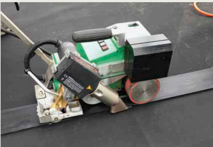
▲ Auf der Baustelle müssen die vorgefertigten Planen nur noch wasserdicht miteinander verbunden werden
