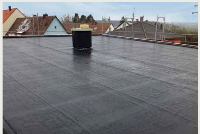
▲ Die Vorteile der EPDM-Planen kommen vor allem bei großen Dachflächen mit wenigen Dachaufbauten zur Geltung
